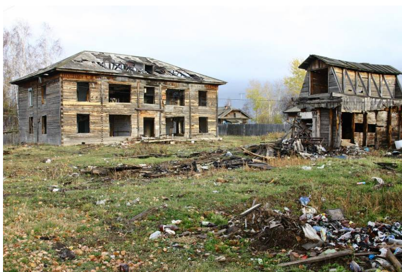
Рисунок 4. Разрушенные объекты инфраструктуры
